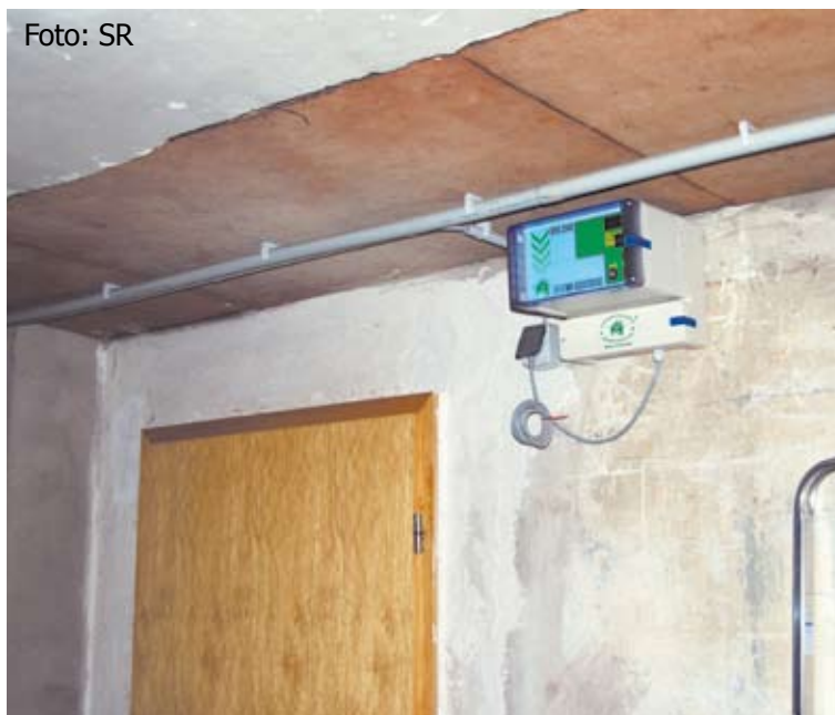
Das BHS-Mauerentfeuchtungsgerät wurde direkt an der Kelleroberseite installiert. Dank seiner Wirkungsweise ist die Feuchtigkeit in Mauern und Fußboden stark zurückgegangen.
